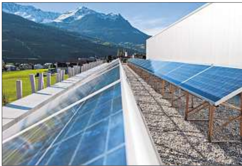
Stehen (auch) zur Besichtigung bereit: Auf dem Dach der Uffer AG in Savognin produzieren über 600 Solarpanels Strom. (zVg)
